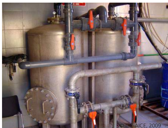
Figura 31. Filtros de arena.
